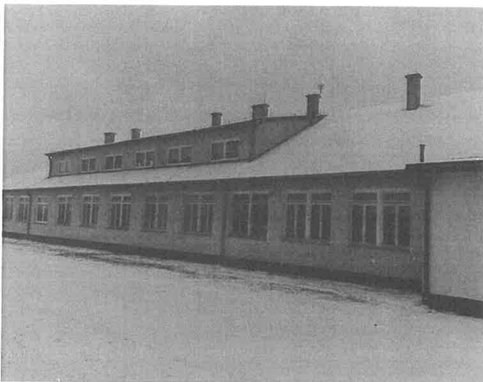
Fot. 4. Budynek SP Szestno – należy zabezpieczyć otwory we wszystkich kominach wentylacyjnych.
