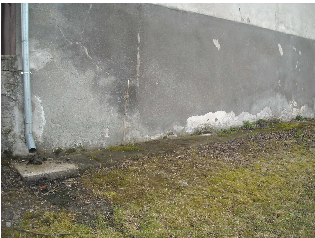
Fot 9. Widoczne uszkodzenia spowodowane wodami rozbryzgowymi.
