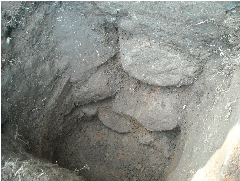
Fot 1. Odkrywka ściany fundamentowej – brak izolacji pionowej.
