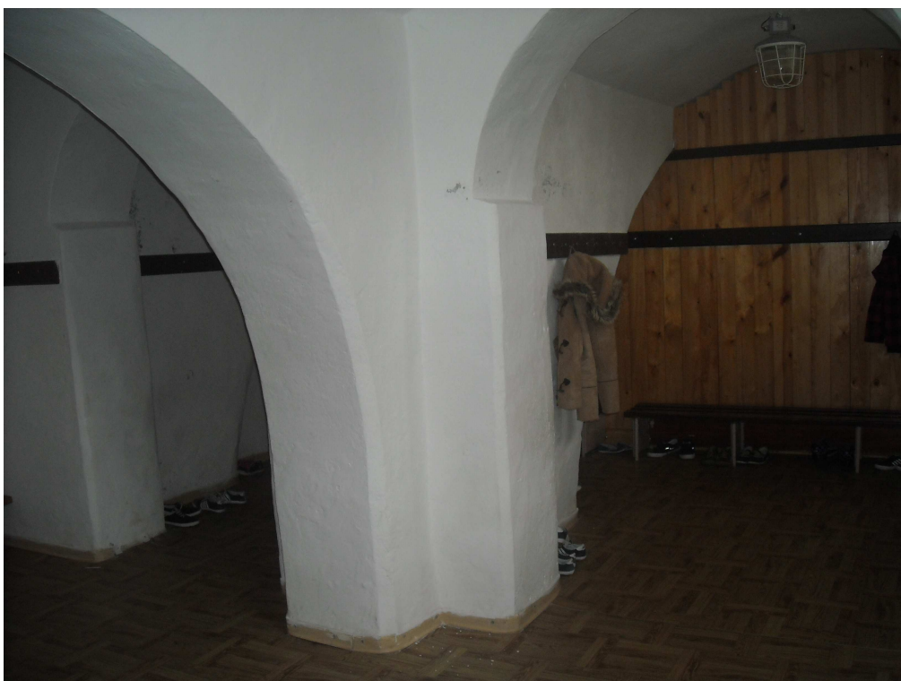
Fot 8. Skorodowany tynk na filarze wewnętrznym.
