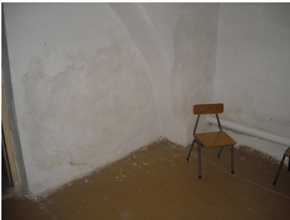
Fot 2. Widoczne zawilgocenie połączone z wykwitami solnymi.
