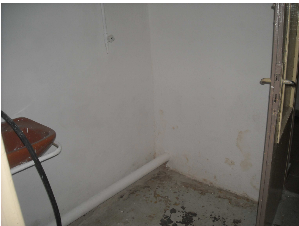
Fot 4. Widoczne przebarwienia tynku spowodowane zawilgoceniem murów.
