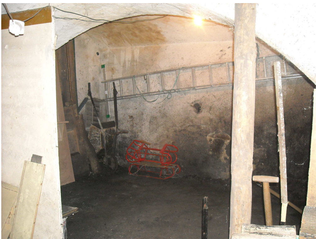
Fot 6. Uszkodzenia wywołane zawilgoceniem ścian w dawnym składzie opału.
