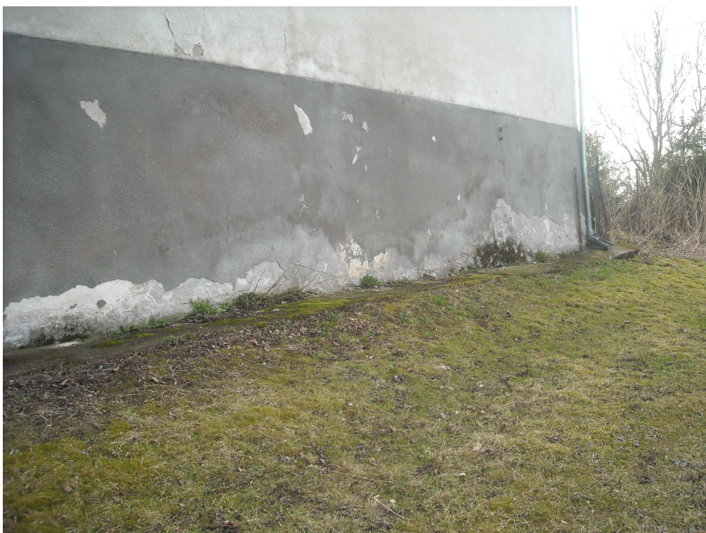
Fot. 10 Uszkodzenia wypraw w strefie opaski betonowej.
