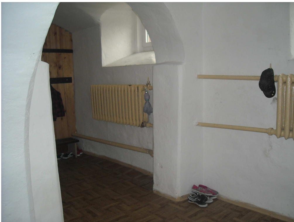
Fot 7. Uszkodzenia wypraw spowodowane wilgocią
