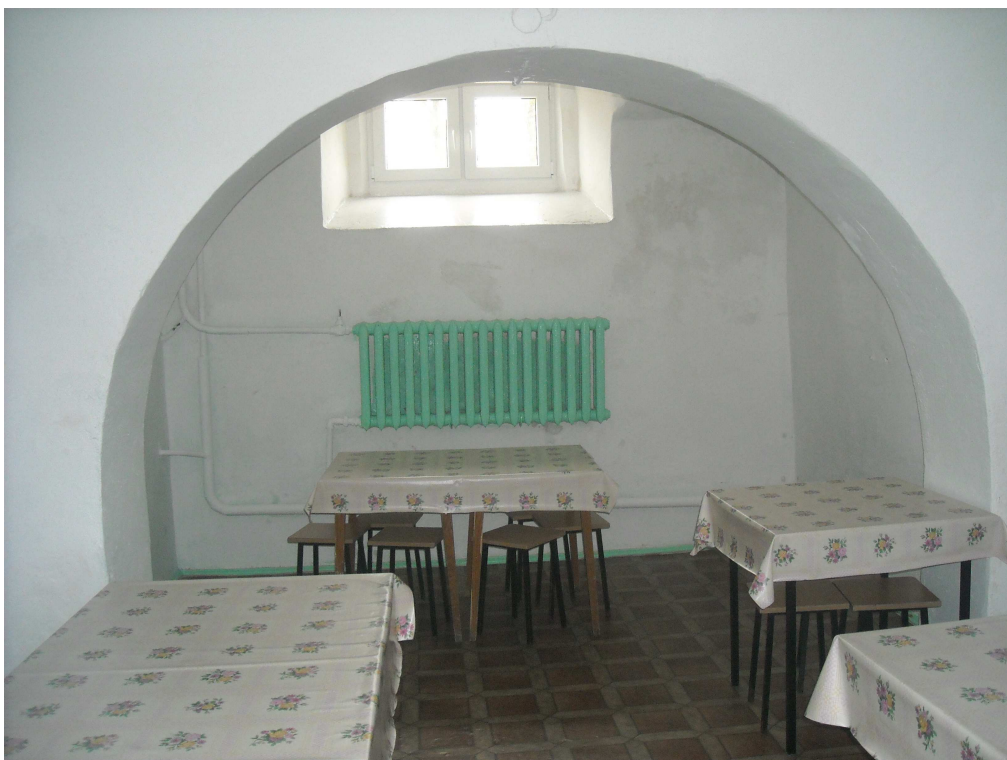
Fot 3. Zawilgocenia muru na całej wysokości ściany.
