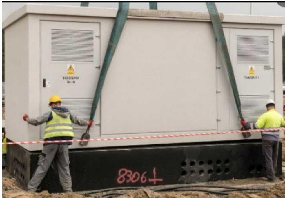
Fot. 6 Kontenerowa stacja transformatorowa nN/SN (Źródło: https://www.lm.pl )
