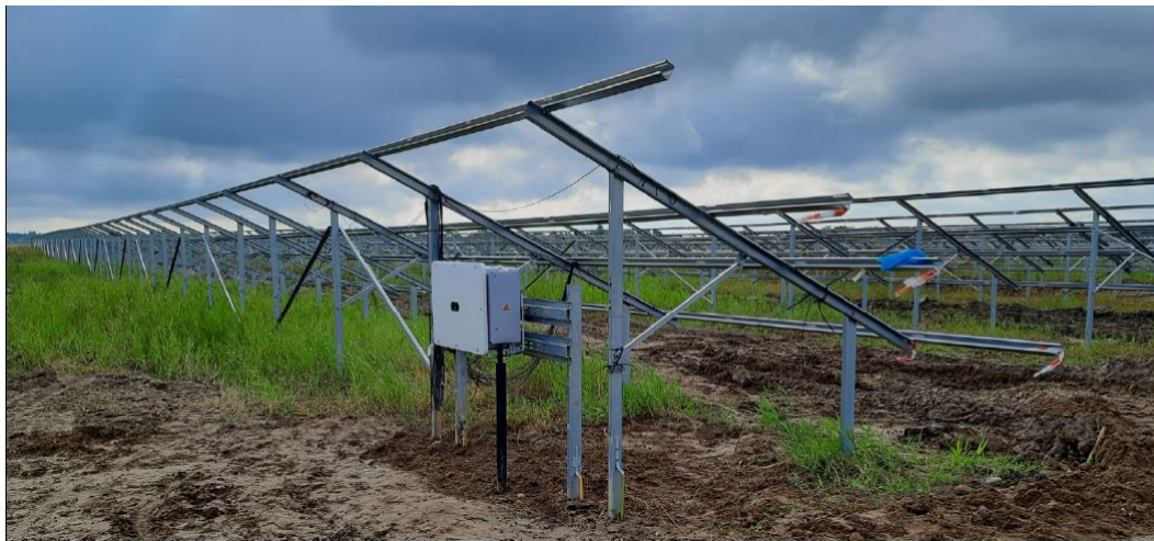
Fot. 4,5 Panele fotowoltaiczne, Konstrukcje- stelaże pod moduły fotowoltaiczne ( Źródło: archiwum Energa Green Development Sp. z o. o. – budowana farma fotowoltaiczna w Przykonie „PV Gryf” należąca do Energa OZE S.A.)
