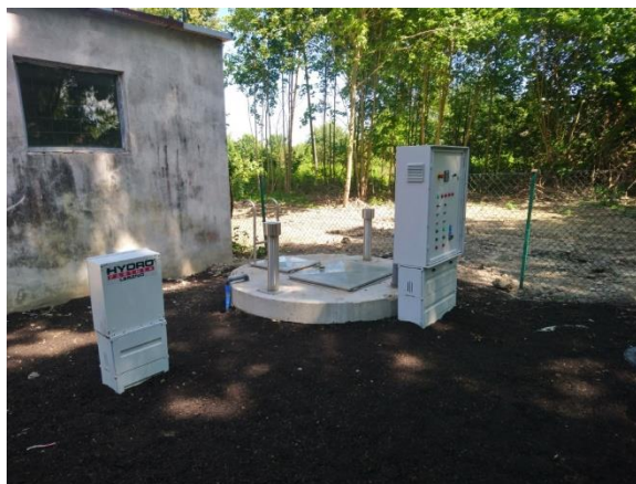
Fot. Stacja podnoszenia ciśnienia zbiornikowa w Szestnie
