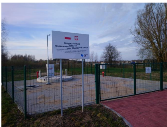
Fot. Stacja na ul. Młodkowskiego do podnoszenia ciśnienia wody dla miejscowości Lasowiec.
