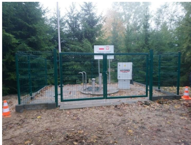
Fot. Przepompownia ścieków strefowa w Rydwągach
